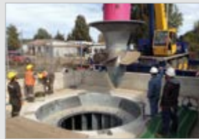
Montage vor Ort
